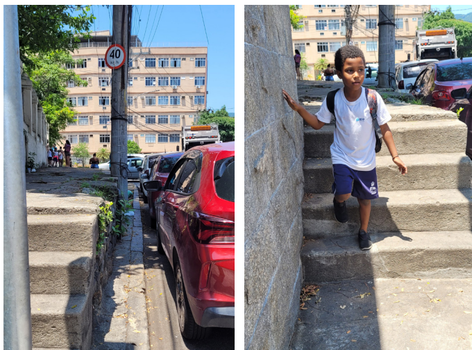
Figura 29. Desníveis acentuados na calçada da E. M Floriano Peixoto
