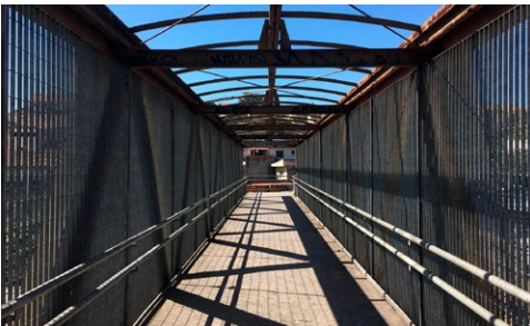
Passarela de acesso ao CEU, perto da Rua Francisco Salles Malta Júnior, com alta insegurança, baixa visibilidade e ausência de cobertura. Foto: Autores
