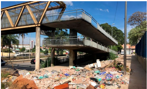
Um dos acessos à passarela em frente ao CEU Azul da Cor do Mar apresenta acúmulo de entulho Foto: Autores.
